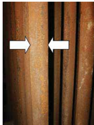
Fig. 4.3 b. Imatge tub recobert amb A-420 amb un estat de degradació del recobriment avançada
