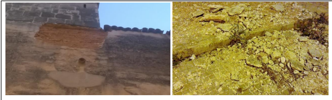
Figura 156. Desprendimiento de parte del muro en el convento de Santa Elisabet (noviembre 2015)
